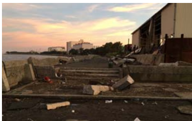
【護岸の崩壊状況】
