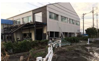
【建物の被災状況】
