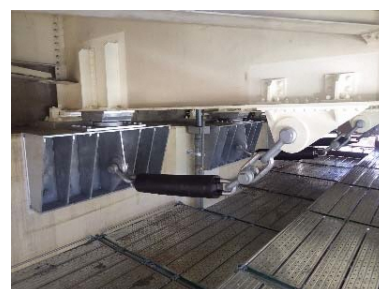
橋梁の耐震化(落橋防止装置の様子)
