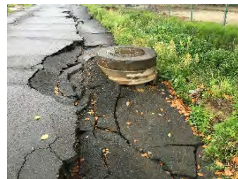
下水道施設の被害状況 平成28年熊本地震
