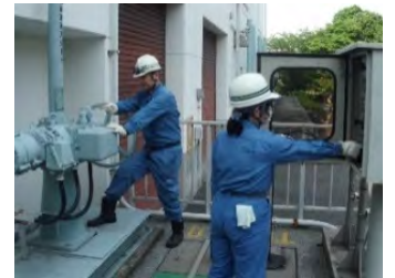
水処理設備の維持管理
