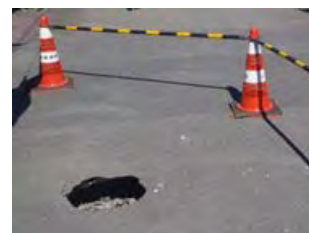
Zパイプ破損による道路陥没
