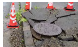
マンホール浮上被害状況
