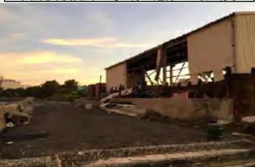
令和元年度台風15号の際の建物の全壊の様子
