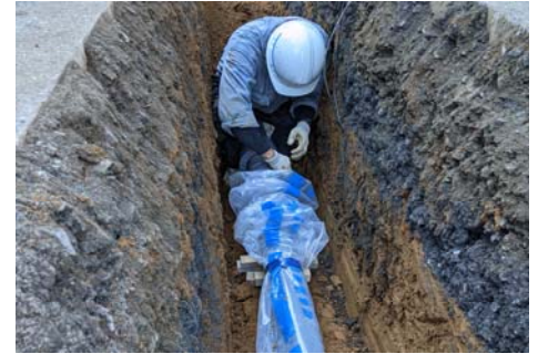
ポリエチレンスリーブを施した水道管
