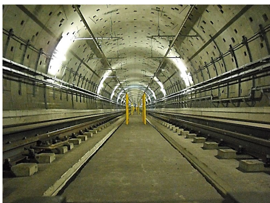
<トンネル照明>
