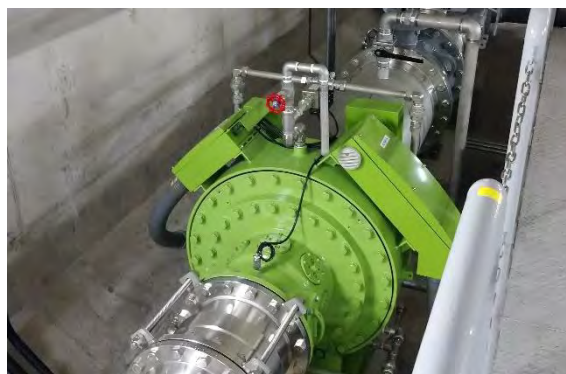
小水力発電設備（今井配水池）
