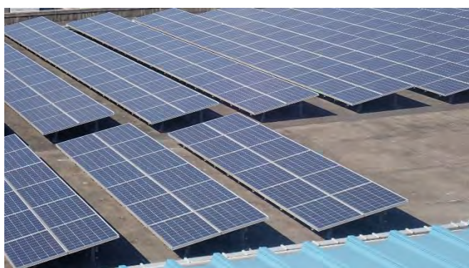
太陽光発電設備（川井浄水場）
