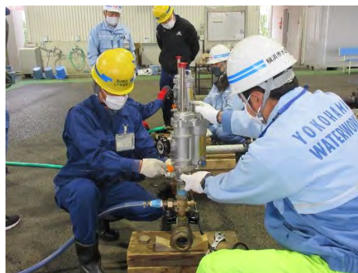
横浜市水道局と名古屋市上下水道局の技術交流会の様子
