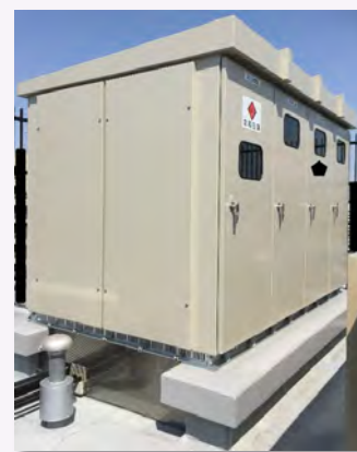
高圧一括受電の受変電設備
