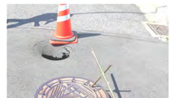
取付管破損による道路陥没
