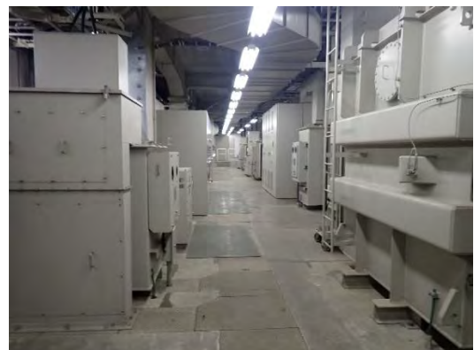
&lt;変電所機器&gt;
