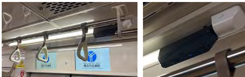
<3000S形車両に設置した防犯カメラ>
