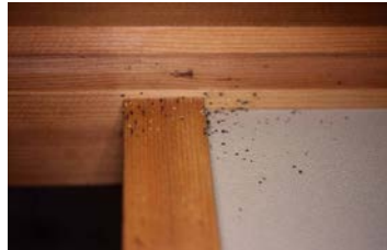
壁や柱の隙間
