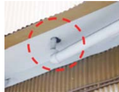
配管の貫通部のすき間にも注意を
